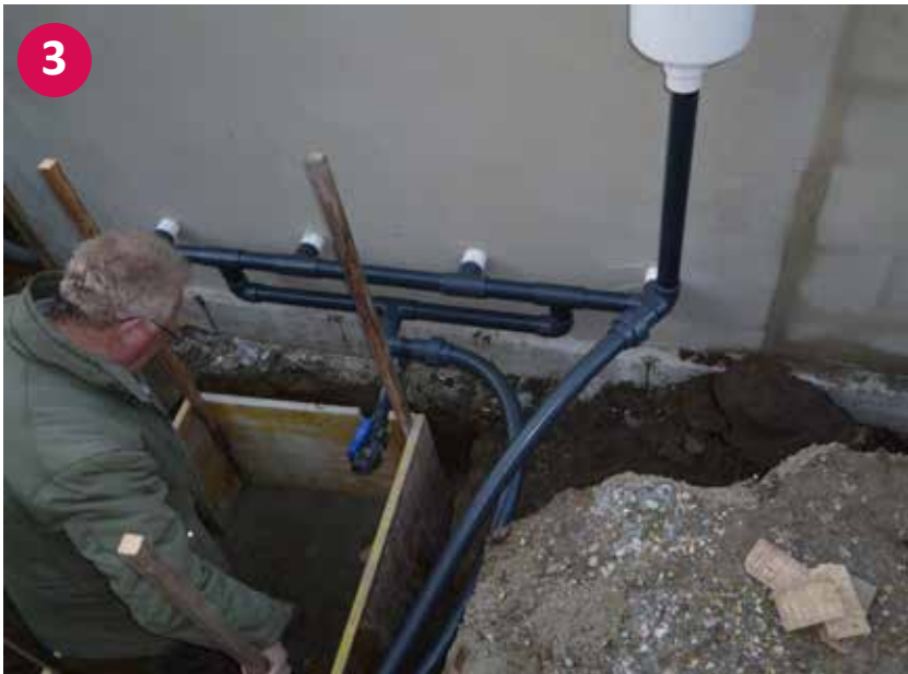
▲ Verrohrung von Düsen, Skimmer und Bodenablauf
