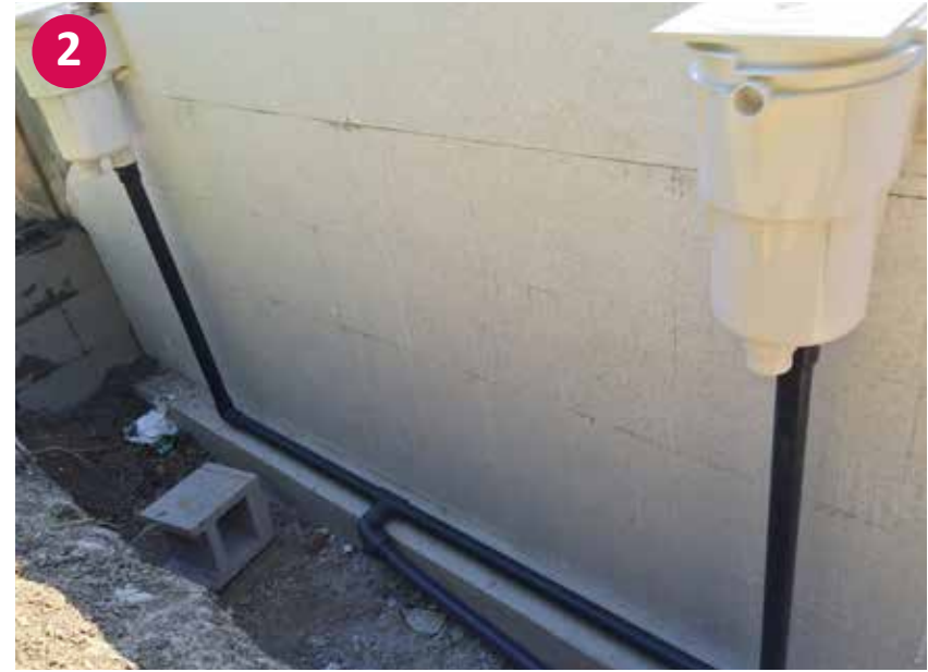
▲ Verrohrung von 2 Skimmer
