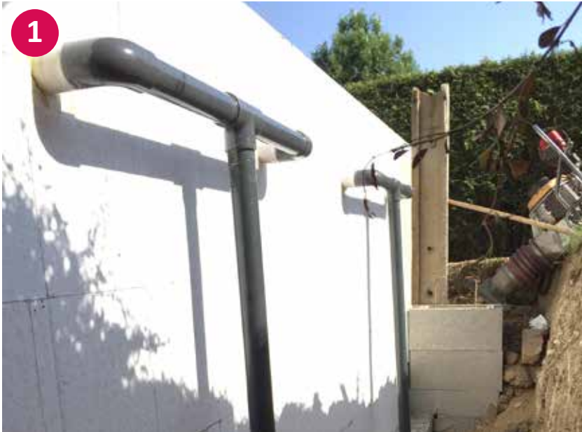
▲ Verrohrung von 4-Düsen
